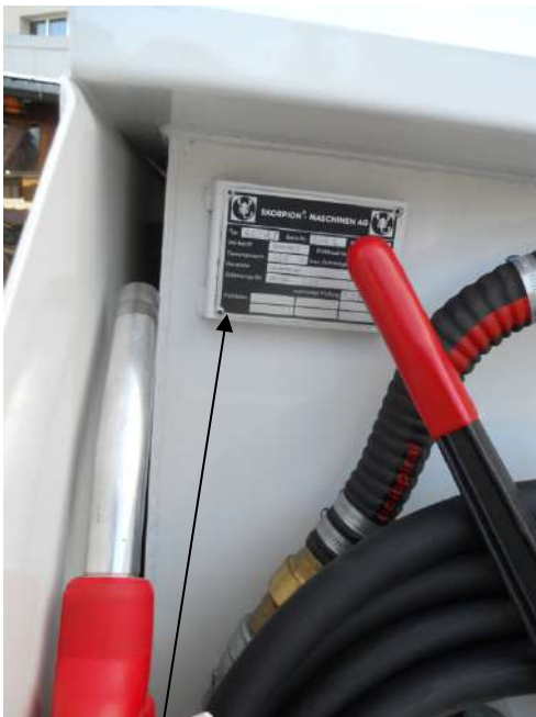
Bild 14 Typenschild im Baustellentank
